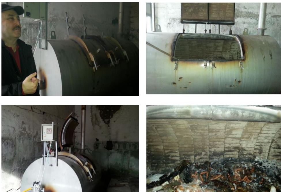
Рис. 3. Процесс термического обезвреживания биологических отходов на установке ГБУ «Ветубой» по ул. Тельмана
