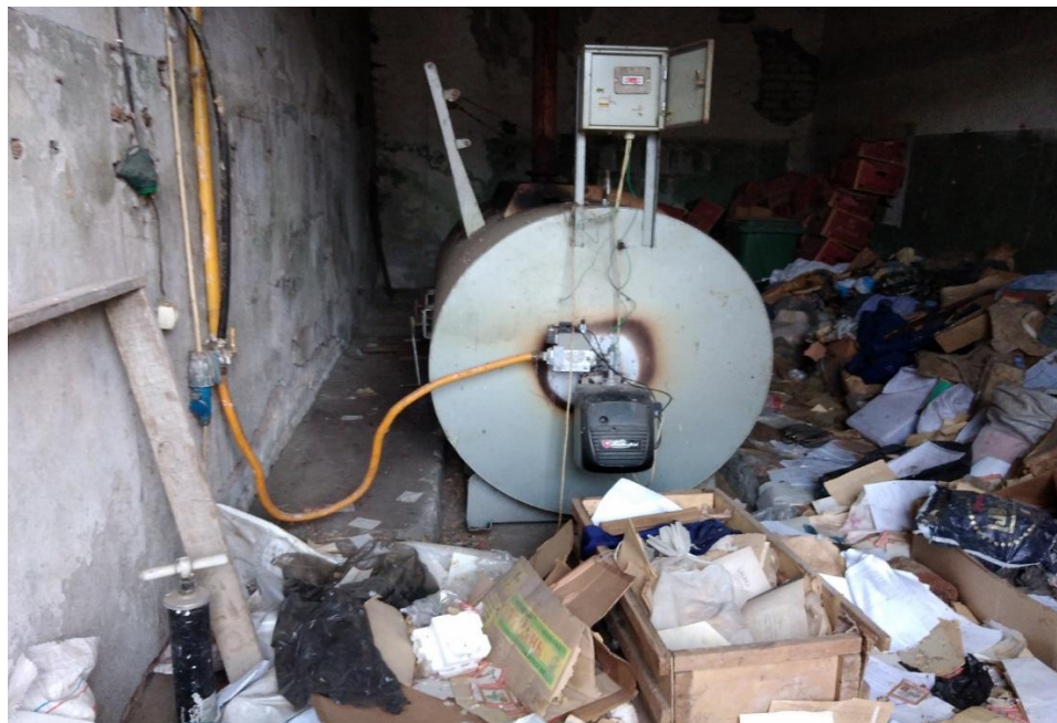
Рис. 4. Установка термического обезвреживания биологических отходов на ГБУ «Ветубой» на новом месте
