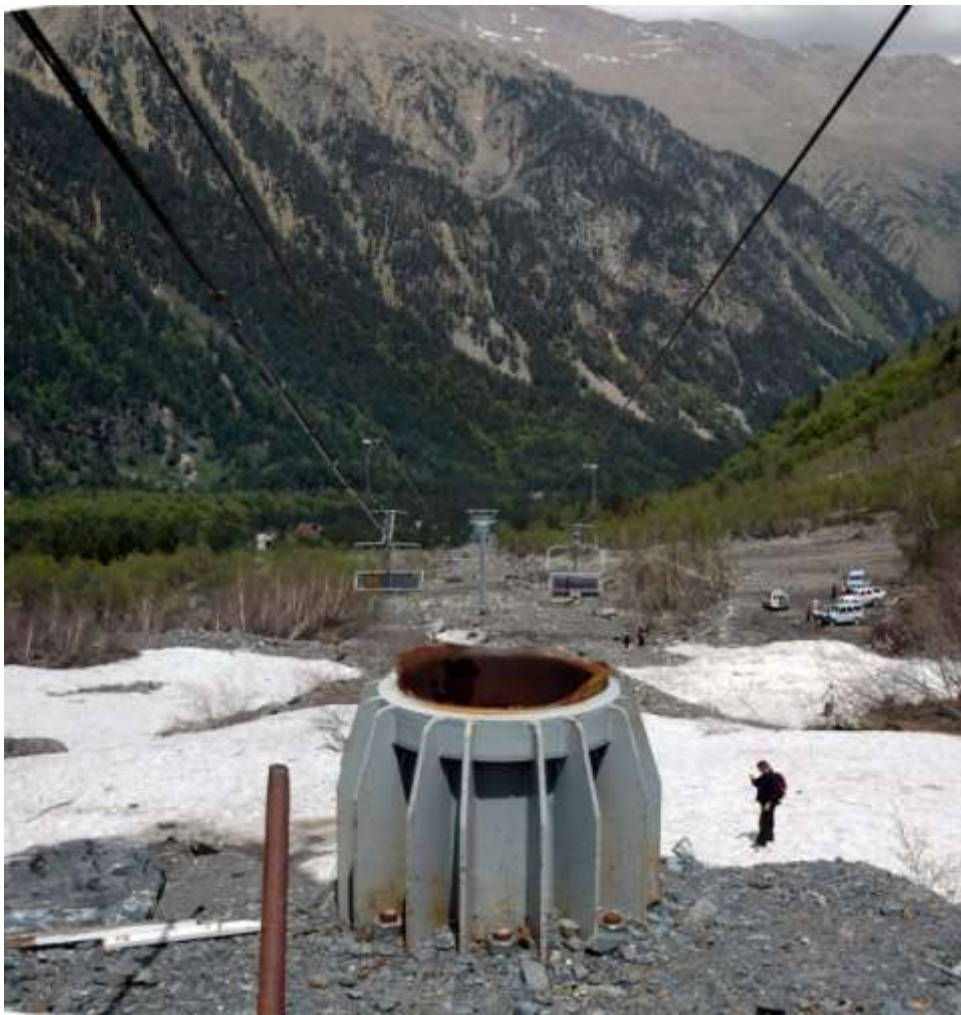
Рис. 2. Срезанная лавиной одна из опор канатной дороги. 2005 г.
