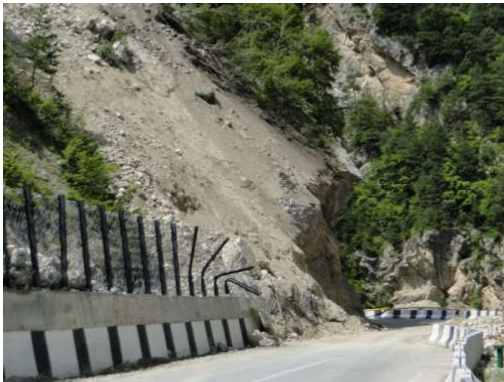
Рис. 1. Разрушенное обвалом защитное сооружение автодороги в Дигорском ущелье в 2016 г.
