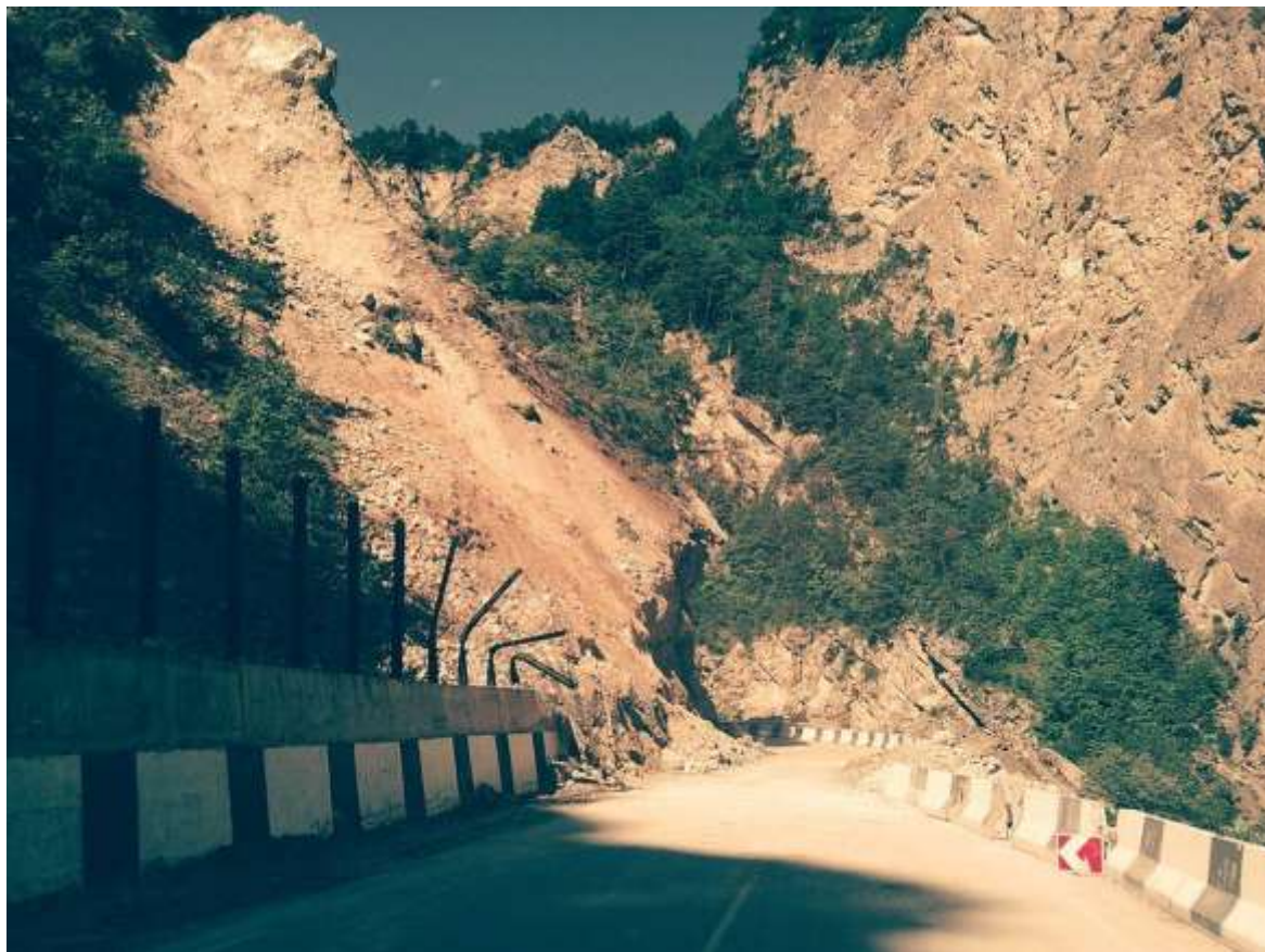
Рис. 3. Последствия столкновения селевого потока с противоселевыми инженерными конструкциями.
