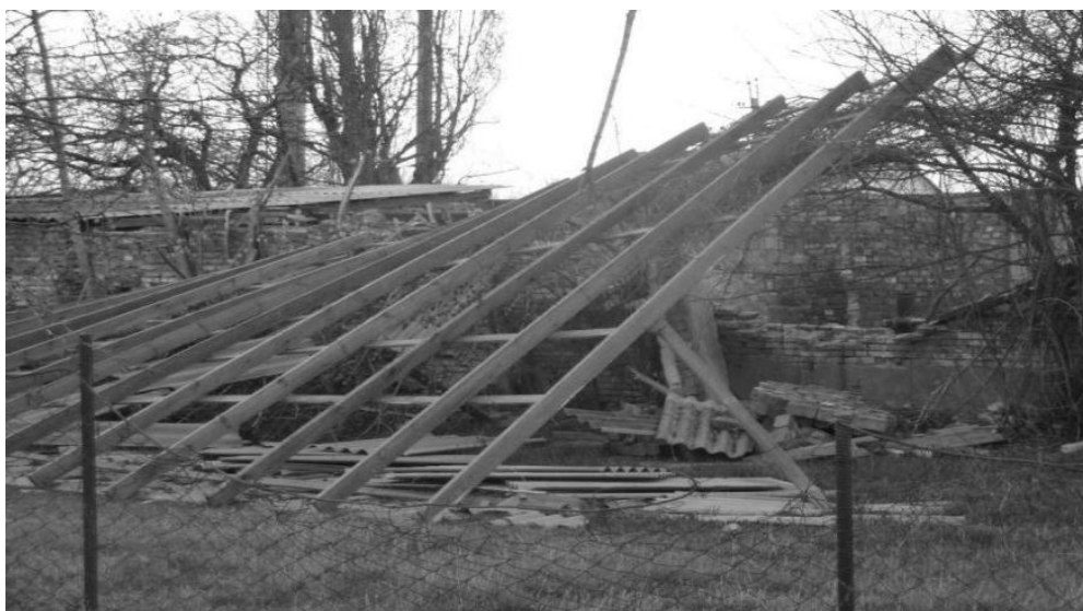
Рис. 5. Последствия урагана 17 марта 2014 года. Разрушение покрытия одноэтажного здания
