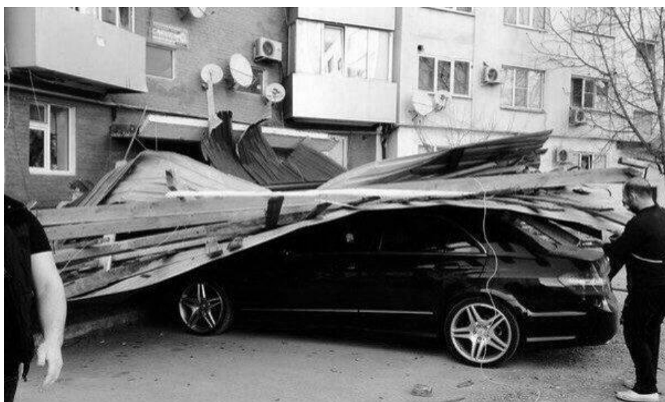
Рис. 6. Последствия урагана 17 марта 2014 года. Обрушение металлической кровли жилого дома
