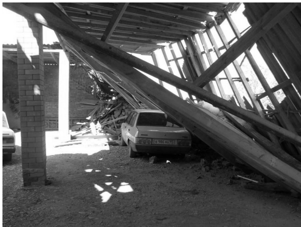
Рис. 8. Обрушение стеновых конструкций и кровли здания при Курчалойском землетрясении 11 октября 2008 года
