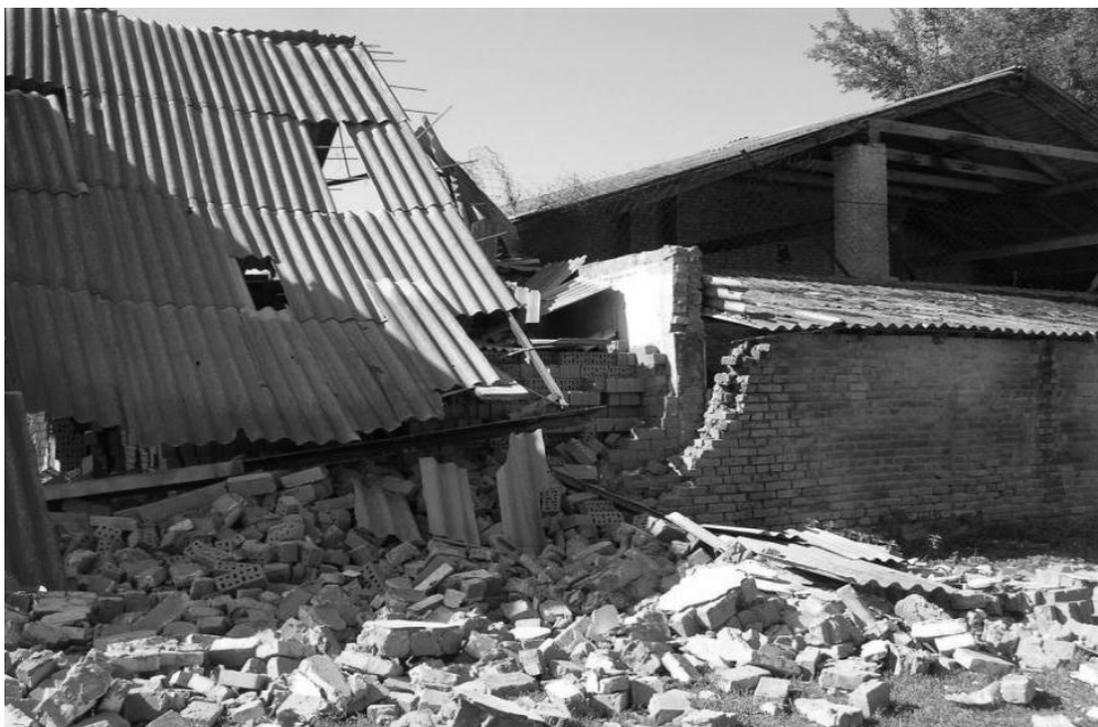
Рис. 7. Обрушение застройки при Курчалойском землетрясении 11 октября 2008 года
