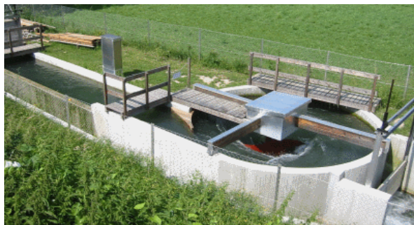
Рис. 2. МикроГЭС с основным технологическим оборудованием
