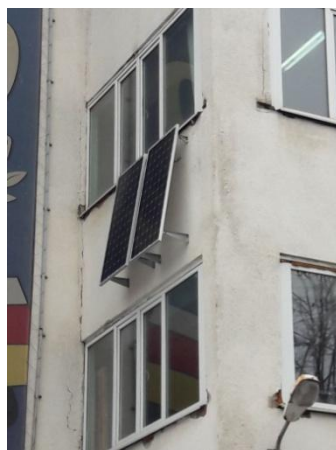
Рис. 1. Вид из окна лаборатории после установки солнечной электростанции
