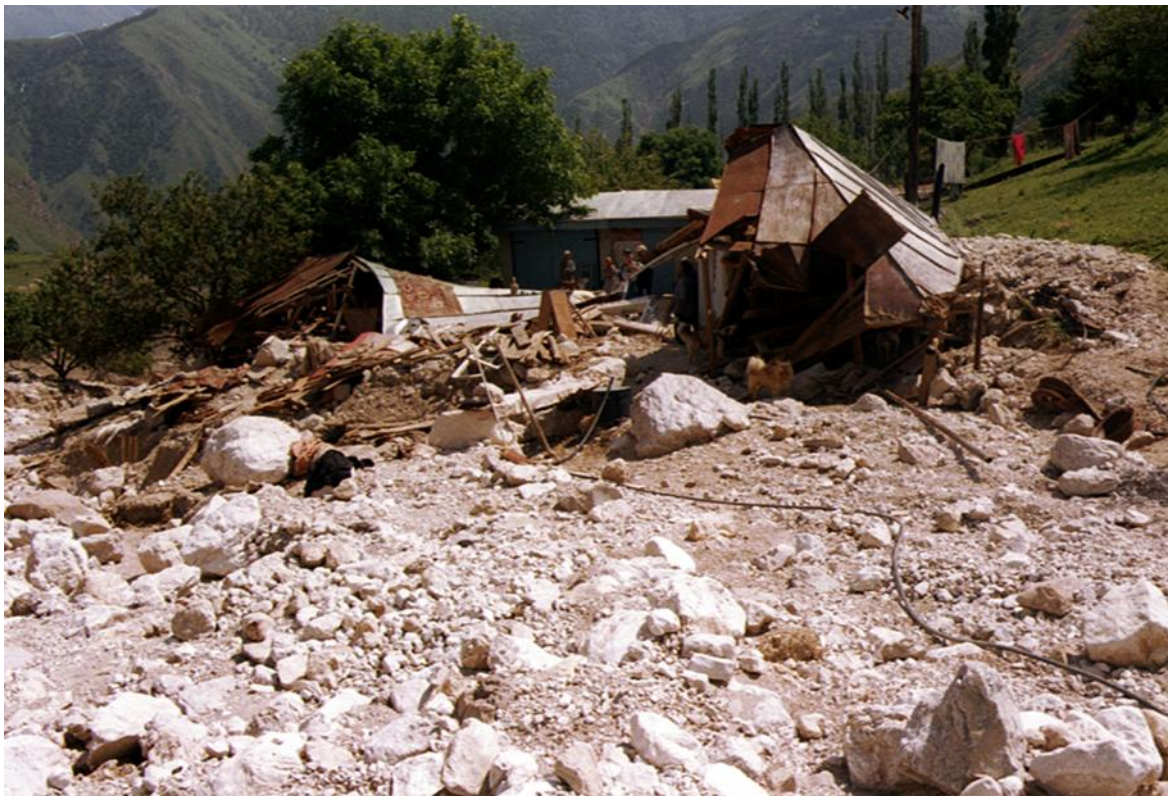
Рис. 6. Разрушение и отсадка стен жилого дома в результате оползневой подвижки склона (п. В. Мизур)
